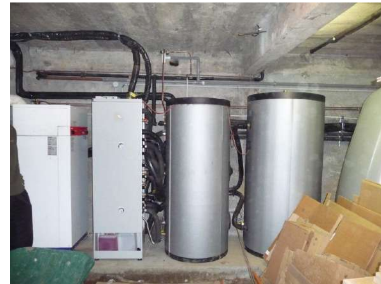
Chaufferie avec une solution SSC solaire direct
