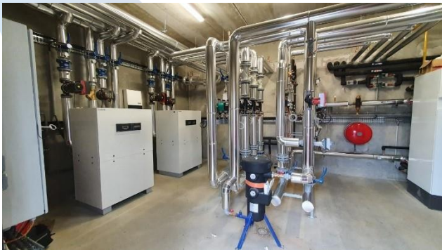
Chaufferie avec PAC et appoint gaz
